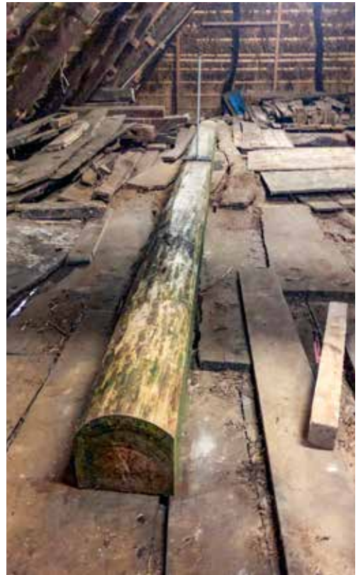
9 Der Überzugsbalken im Dachraum des Hauses ist durch eine Gewindestange mit dem Balken verbunden (Foto: Dörfler, 2023)
