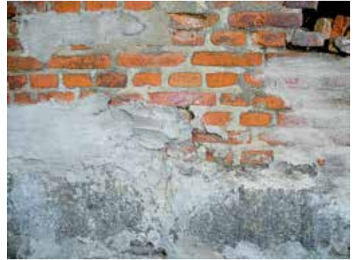
4 Alte Ausbesserungen mit Zementmörtel
