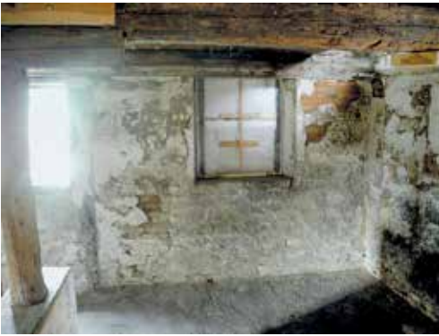
1 Mit Zementmörtel angeworfene und überputzte Teile der Wandinnenseite (alle Fotos in diesem Bericht: Stephan Bastian)
