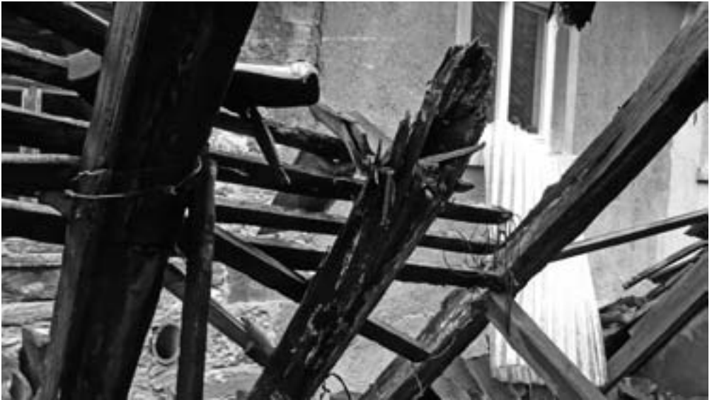
Auch die Sparren waren durch die jahrelange Durchfeuchtung deutlich geschädigt.
