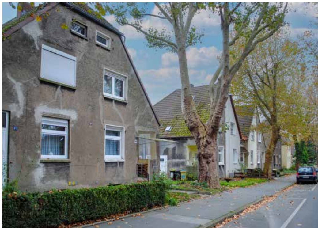
19 1903: „Mülersiedlung“, Werksiedlung der Zeche Gneisenau in DO-Derne, Müserstraße; verschmierte Risse in den Fassaden belegen die anhaltende Bergsenkung, verschiedene Putze die Besitzsplitting im Zuge der stattgefundenen Privatisierung (Foto: Verf. 2014)
