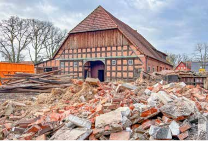
22 Abriss einer Hofanlage in Martfeld (Lkr. Diepholz), Januar 2023. Von dem Zweiständer-Hallenhaus von 1821 (im Hintergrund) soll zumindest die Fassade erhalten bleiben. (Foto: Bernd Kunze)
