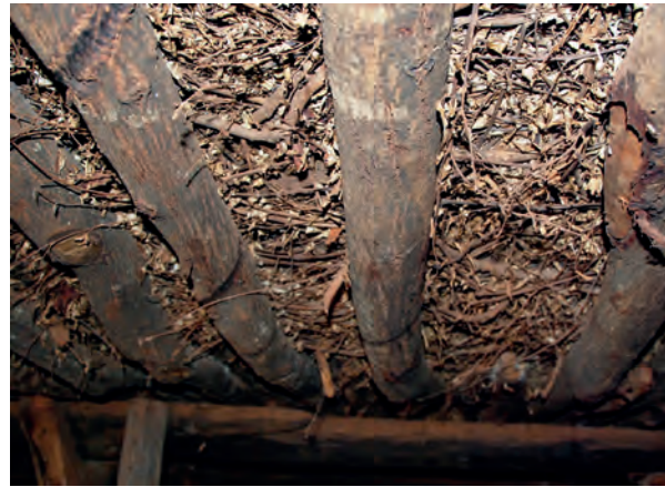
16 Strauchpackung von insektenabweisenden Sträuchern über der tragenden Holzkonstruktion in einem Iraqw-Erdhaus (Foto: Dr. Christoph Langner)
