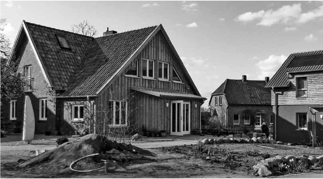
4 Der frühere Stall mit Küche und Arbeitsraum wird bereits während der Umbauphase genutzt.
